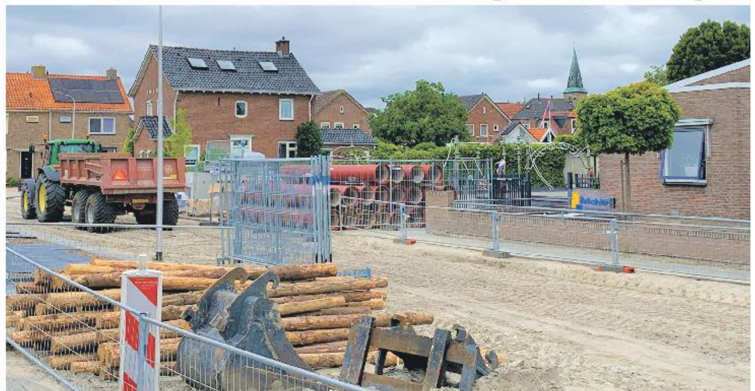
De reconstructie aan de Jan van Nassastraat is begonnen met de aanleg van een nieuw riool. Foto: Anja Bos
