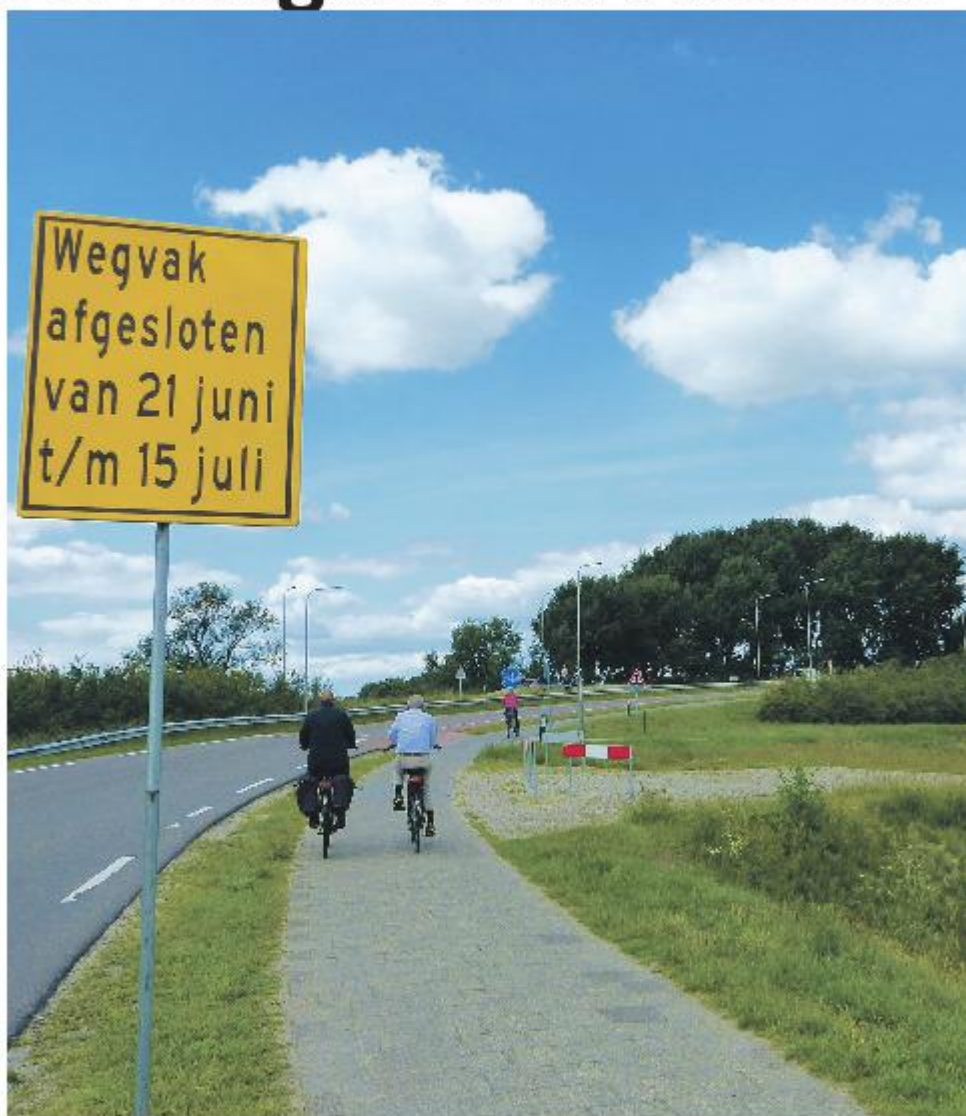
Op dit traject vanaf de brug tot verderop de Hanzeweg wordt onder meer het fietspad verbreed. In een later stadium hoort ook de wijziging van de inrit bij Bremen (rechts op de foto) tot de werkzaamheden. Foto: Anja Bos
