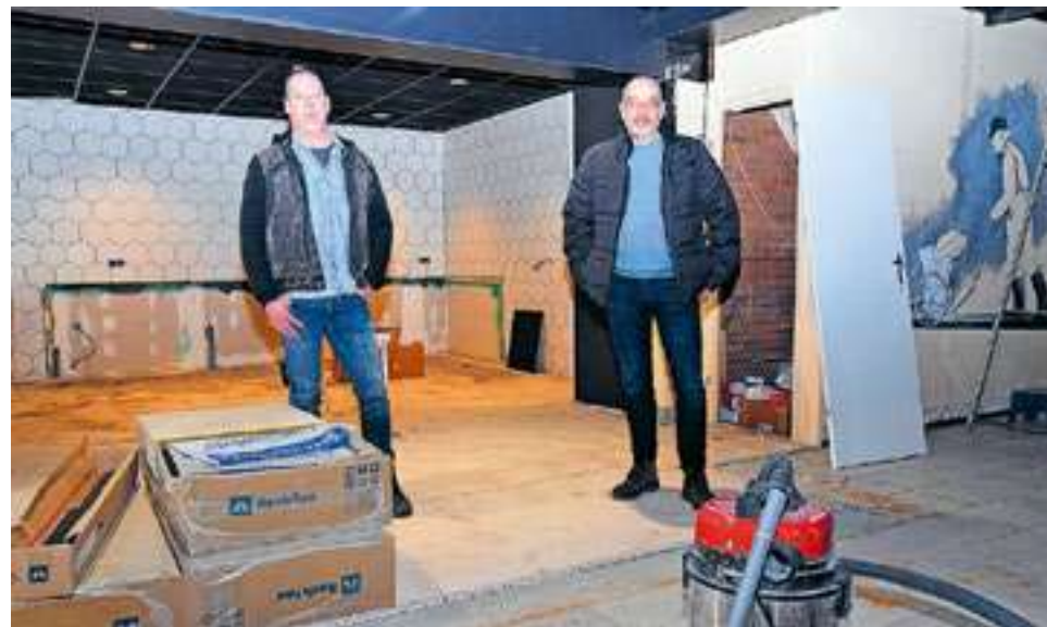
Niels Kranendonk en Marcel Zuidema tussen de bouwmaterialen in de kantine. Foto: Sieb van der Laan.
