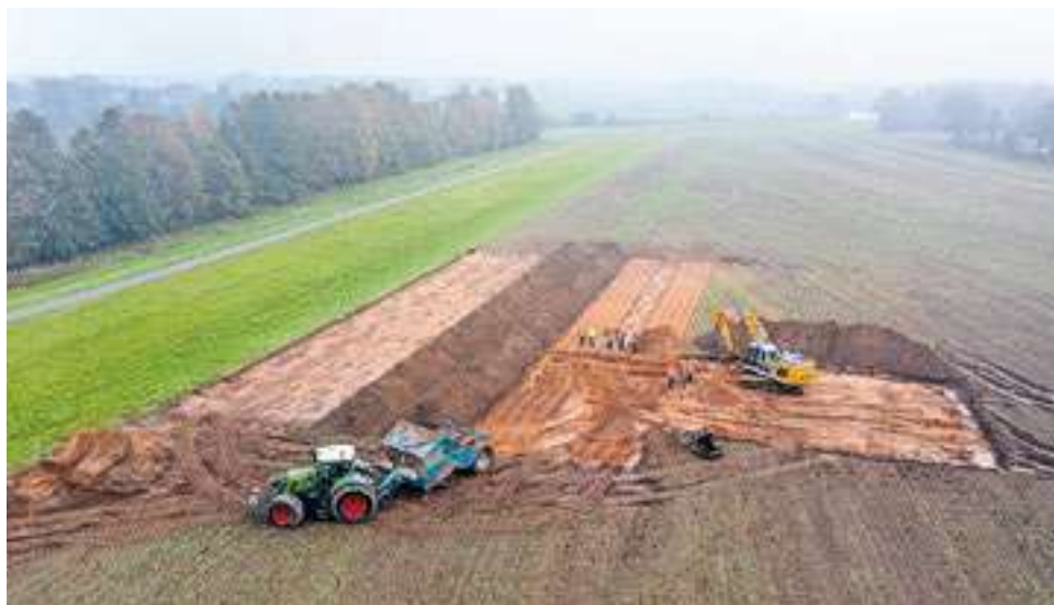
Het waterschap meet of het mengen van de zandgrond met de kleilaagjes voldoende is om het effect van piping langs de Vecht te voorkomen. Foto Demi de Kleine
